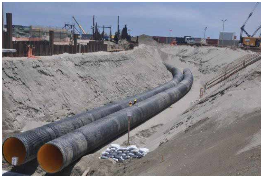
Foto 5.5-2: Curva dada con una tubería
